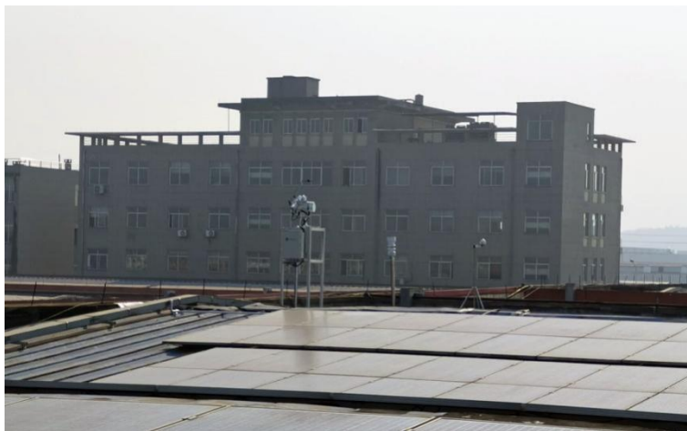
图 50 江苏某分布式光伏电站（屋顶式）
