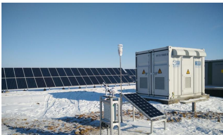
图 51 新疆某大型集中式光伏电站
